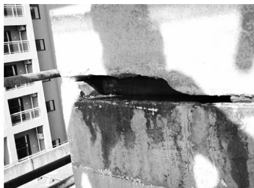
(a) 装配式结构外墙接缝渗漏
